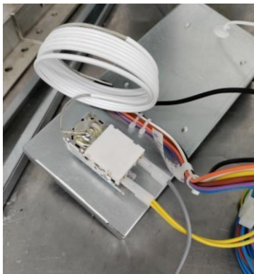
Cuadro máquina 1 cableado kit apilado
