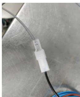
Conexión cable gris #12 y cable negro #1
