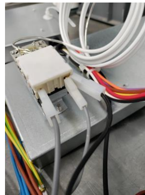
Cuadro máquina 2 cableado kit apilado
